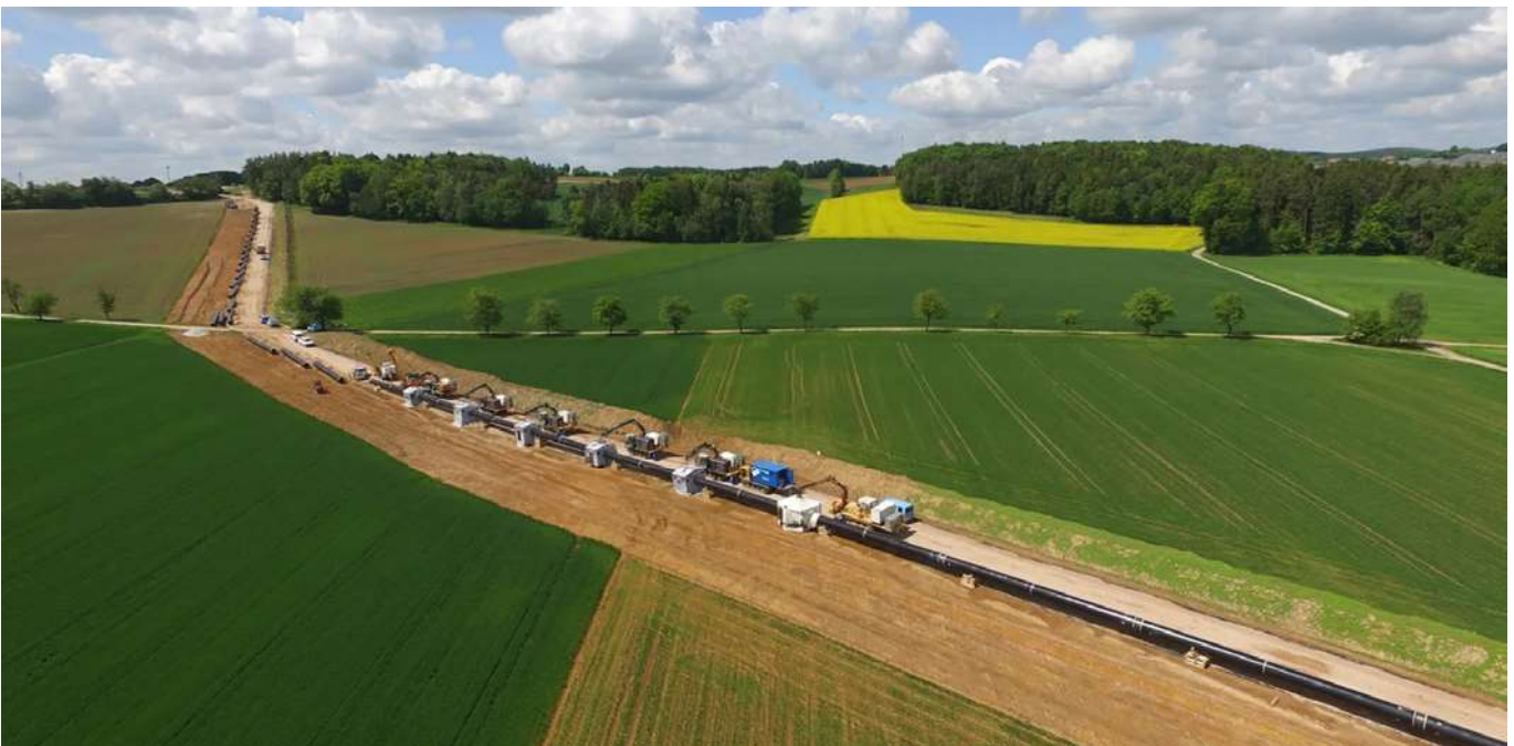
Die OGE betreibt ein Hochdrucknetz mit 11.874 km Gesamtlänge und 994 Auspeisepunkten. Laufend kommen neue Leitungsabschnitte hinzu, so wie hier 2019 ein 77 km langes Verbindungsstück zwischen Forchheim und Finsing in Bayern
